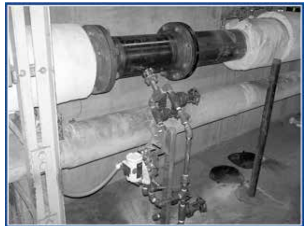
Accelabar dans une conduite de vapeur
