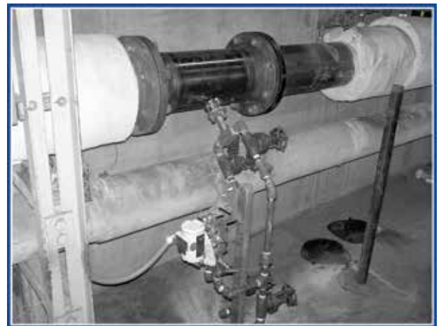
Accelabar en la línea de vapor
